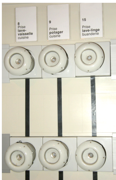
Portion de tableau électrique avec trois groupes (circuits) triphasés protégés par des fusibles de 15 A. On ne voit ici que deux des trois fusibles de chaque circuit.
